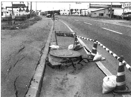
←人孔と路面に生じた段差
