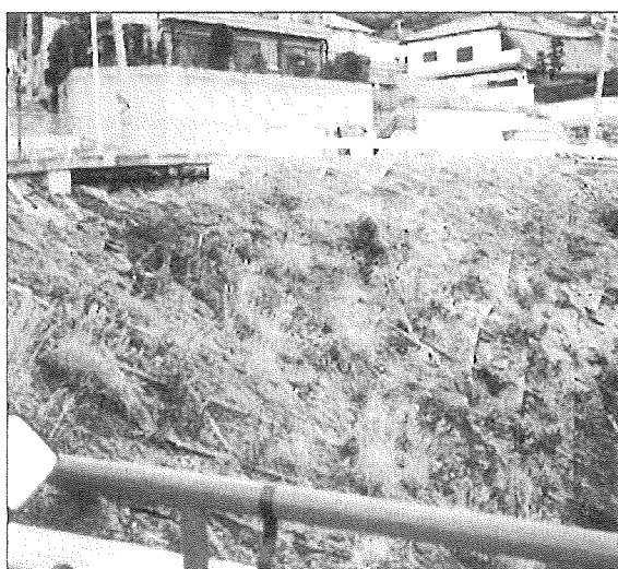
▲東灘区・西岡本台 盛土法面は場所打ちの格子枠工で保護されているが、各所でセン断破壊を起こしている。
