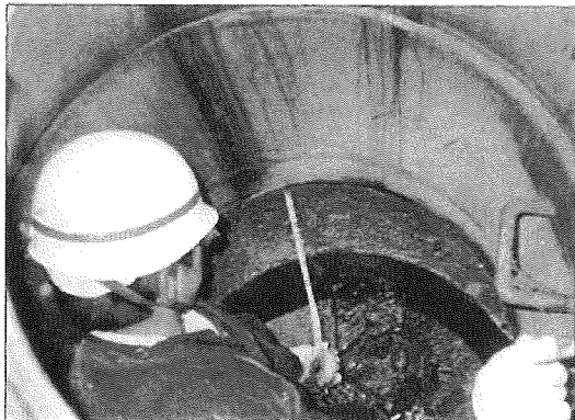
←下水道人孔内、直壁ブロックのずれ
